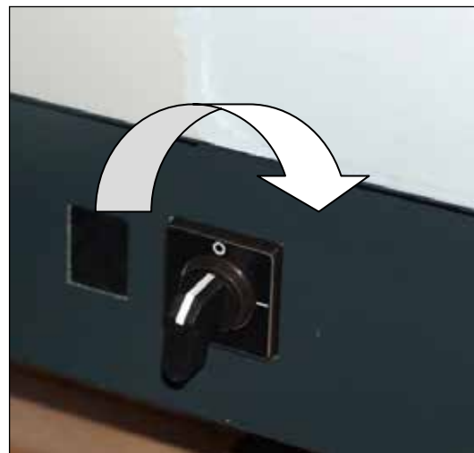
Fig. 14 détail interrupteur général position OFF
