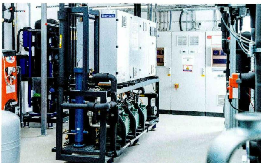
Die neue CO 2 -Kälteanlage Eco2Middle mit FTE-System im Maschinenraum
