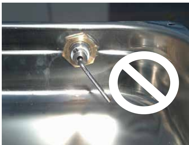
Fig. 23 Detailansicht Füllstandssensor; fehlerhafte Montage
